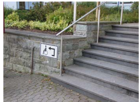
Gefahrenpunkt am zu kurzen Geländer
